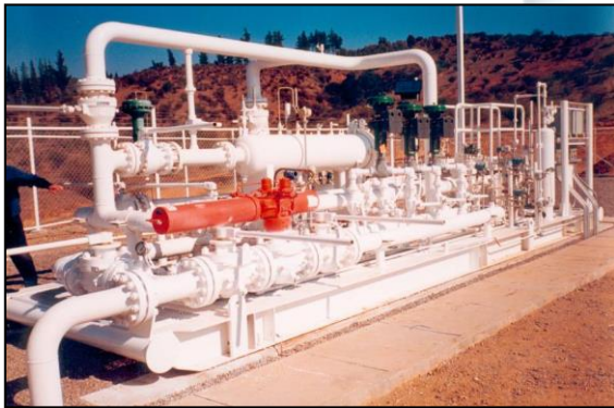
Gasoducto 20" Limache-Colmo (Electrogas)
