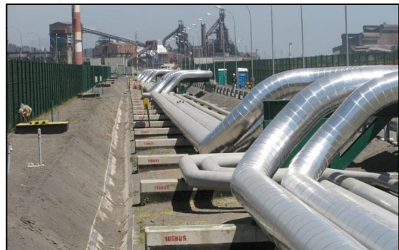
Interconexión Muelle San Vicente Enap Refinerías Bío-Bío
