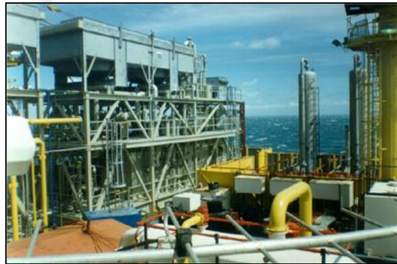
Plataforma de Compresores AM-2
